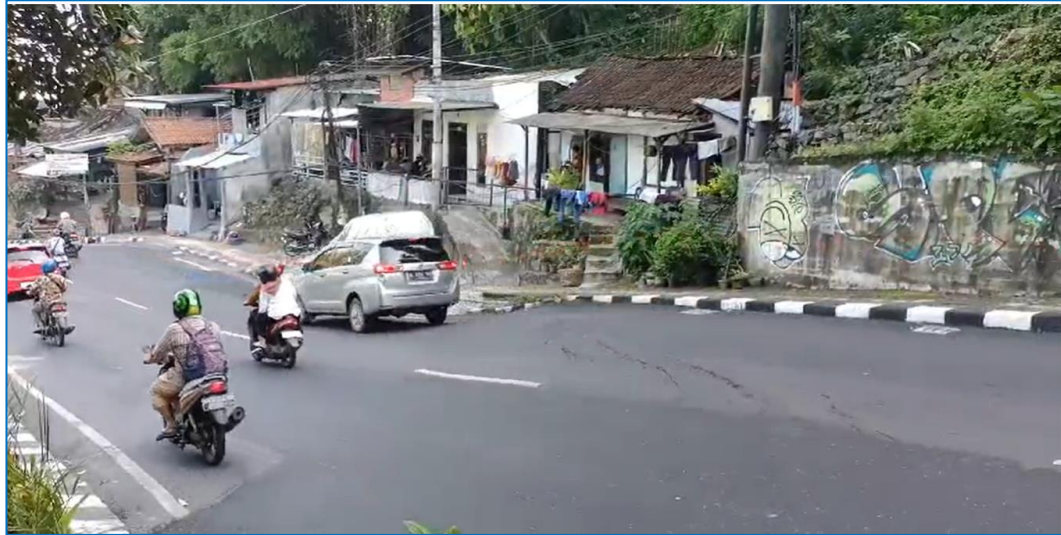
Gambar 2 Lokasi Longsoran Jalan Gombel Lama Semarang Yang Terdeformasi
