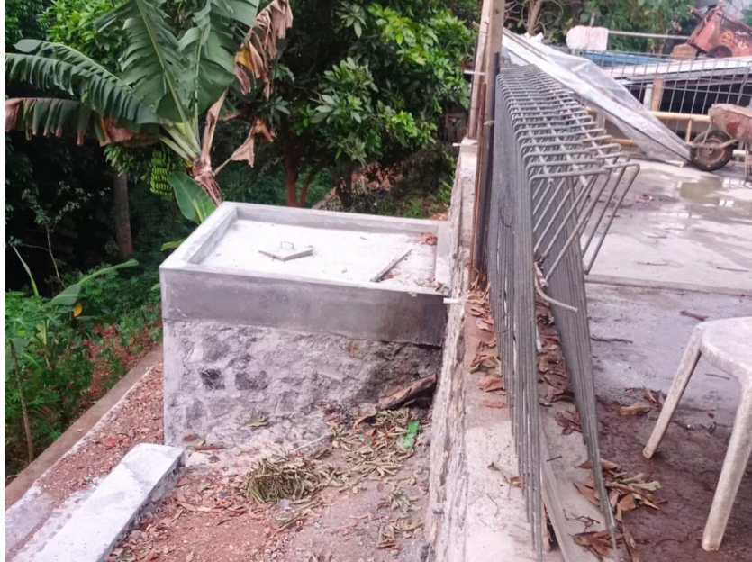
Gambar 5.8. Septic Tank dan Tempat Cuci Yang Sudah Siap Digunakan
